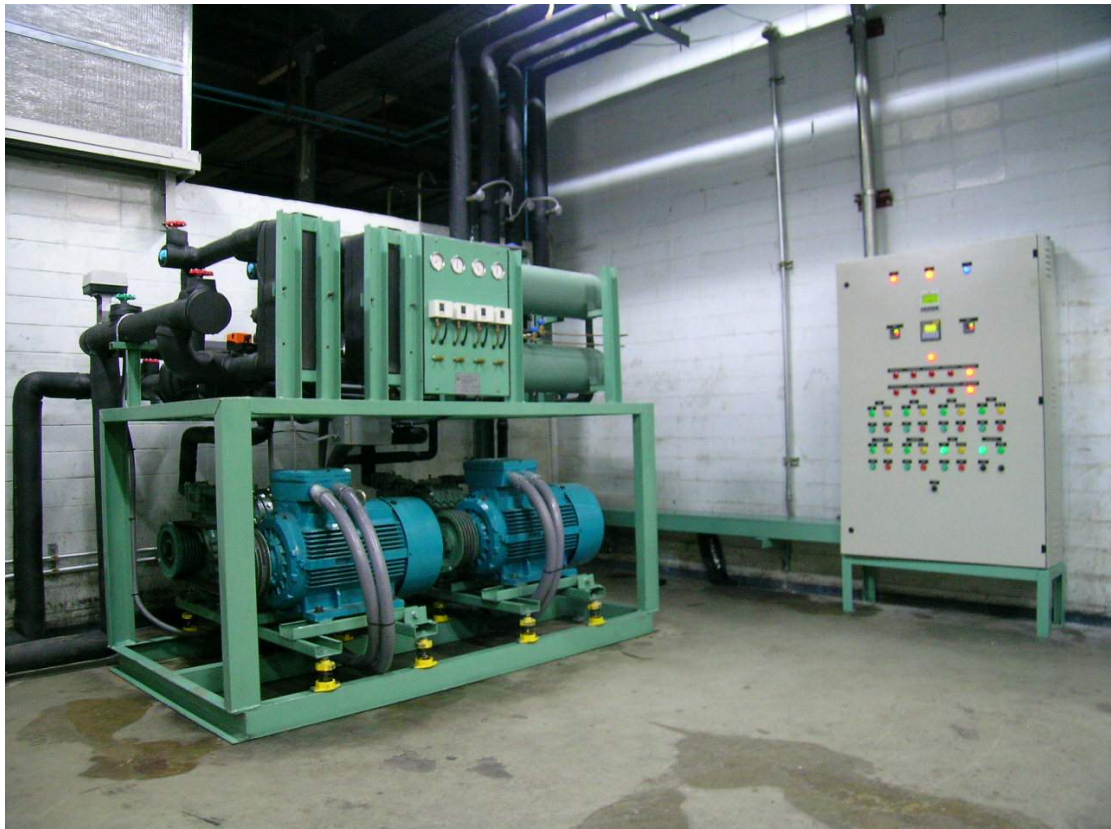
รูปที่ 1. การติดตั้ง Heat Pump โรงงานธนบุรีประกอบรถยนต์
